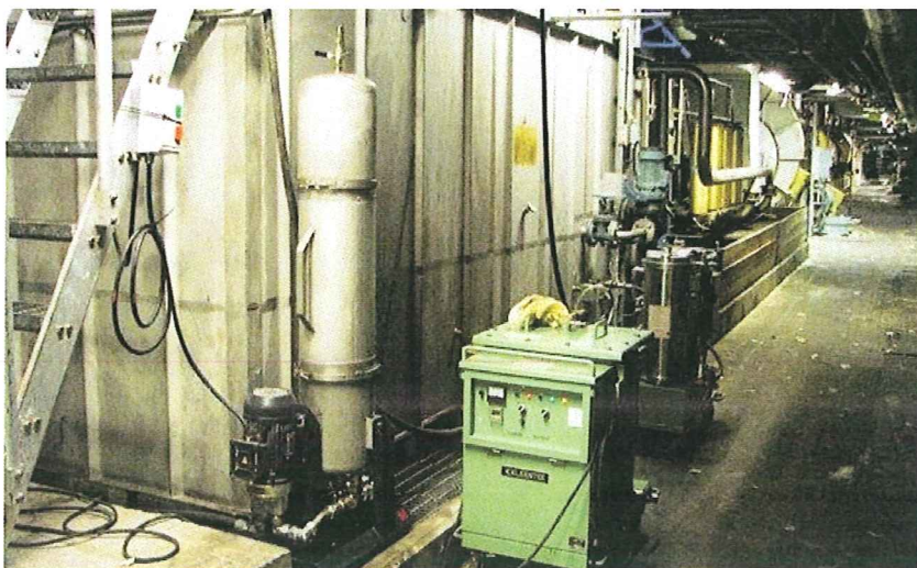
Djupfiltrering av oljan med 1 st konventionell djupfilter och 2 st elektrostatiske filter
