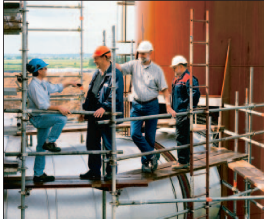
Underhåll och driftservice är numera en fråga om optimering och förebyggande insatser, snarare än akuta utryckningar för att reparera detaljfel. Helhetssyn, samarbete och förtroende är nyckelord.
